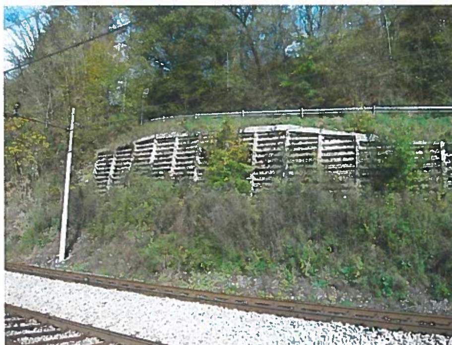
Konstrukcija kašnega zidu brez vidnih poškodb je močno zaraščena
